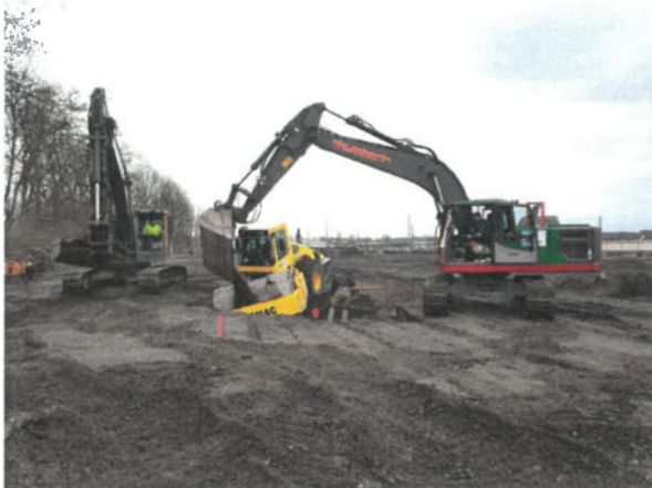
Bild 31: Walze bricht erneut ein; Fall des zweiten Tagesbruchs -2. TB- im Süden der Fläche (29.01.2018)
