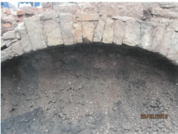
Bild 57: Hohraum zwischen Mauerbogen und Auffüllung; deshalb Abbruch des Bogens, Aushub und Neueinbau (29.03.2018)
