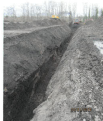
Bild 30: Weiterer Querschurf zur Erkundung der im Untergrund vermuteten Bauwerke und Hohlräume südlich des 1. TB (24.01.2018)
