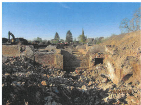
Bild 66: Blick von N nach S; Abbruch der oberflächennahen Mauerwerksreste nach archäologischer Kartierung (19.04.2018)
