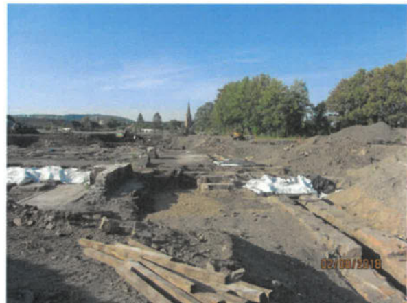
Bild 88: Mit Folie abgedeckte Kontaminationsbereiche; organisch/ölige Verunreinigungen in den Walzenlagern (02.08.2018)
