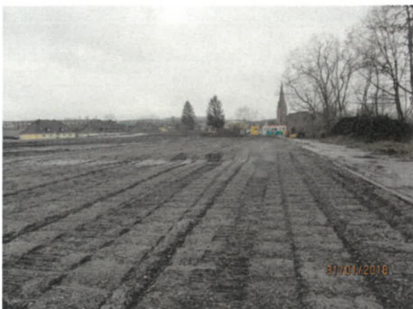
Bild 35: Deutliche Setzungen im Einsatzbereich der Polygonwalze; im ersten Übergang bis zu 15 cm in Folge der Verdichtung (31.01.2018)
