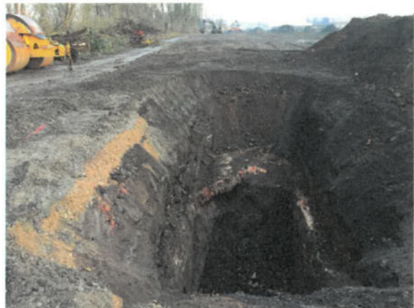
Bild 34: Bereich des zweiten Tagesbruchs nach Sicherung der Walze; auch hier existieren nicht verfüllte Keller-/Hohlräume (30.01.2018)
