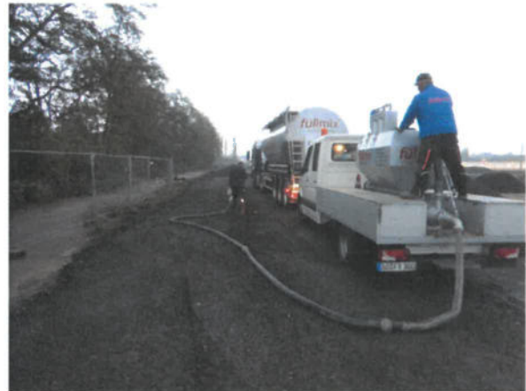
Bild 100: Verfüllung der Kanäle und Hohlräume über die zuvor eingebrachten KG-Rohre mit Kanaldämmung (25.10.2018)
